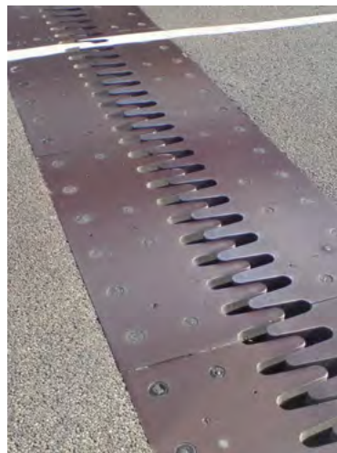
Die uitsettingslas in 'n brug.
