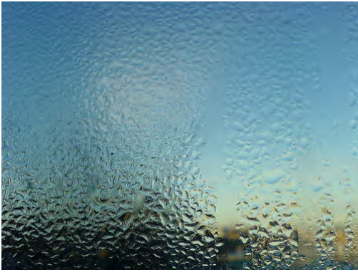
Waterdamp in die lug het op die koue oppervlak van hierdie glasruit gekondenseer.
