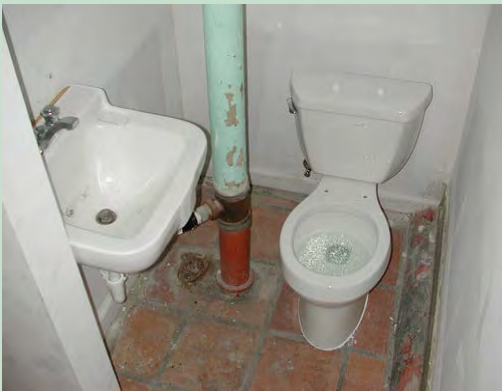
'n Wasbak en toilet.
