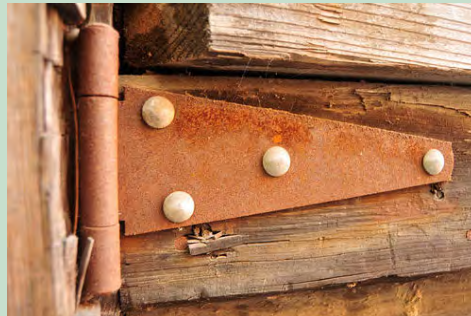
A rusted door hinge.
